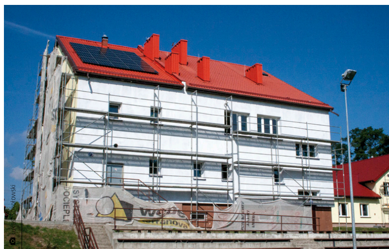
Panele fotowoltaiczne na budynku szkoły w Porzeczcu
