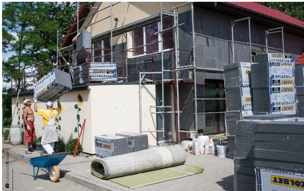
W Porzeczcu już trwają prace związane z termomodernizacją budynku szkoły. Na wydajniejszy zostanie również wymieniony piec centralnego ogrzewania
