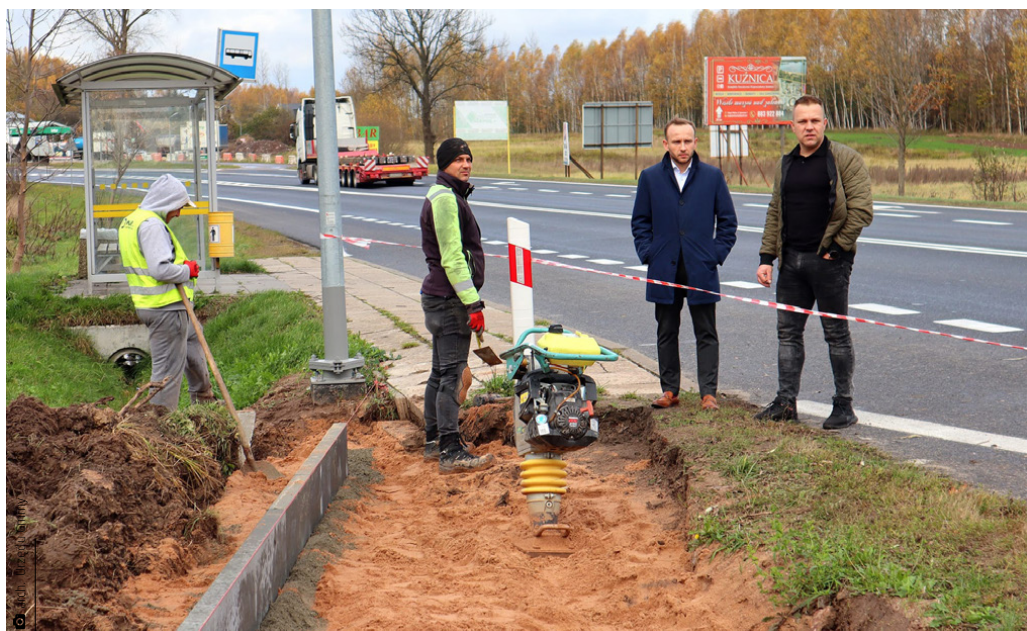
Wójt Damian Sławski wraz z radnym Łukaszem Woźniakiem wizytują budowę chodnika wraz z oświetleniem w Wyrowcach
